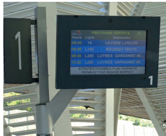
Panneau d'affichage dynamique en gare d'Aix-en-Provence situé en tête de quai (photo : Cerema)
