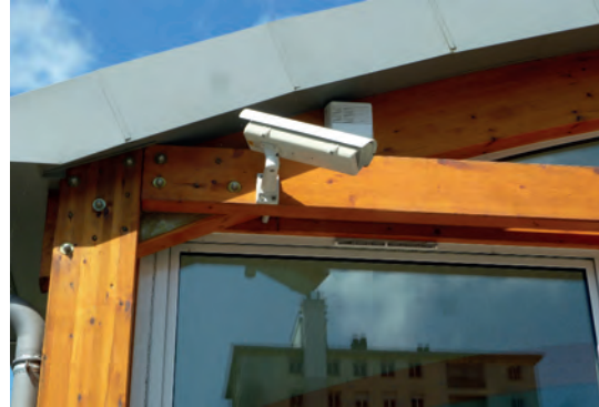
À Épinal, une vidéoprotection est en place sur le parvis de la gare routière (photo : Cerema)
